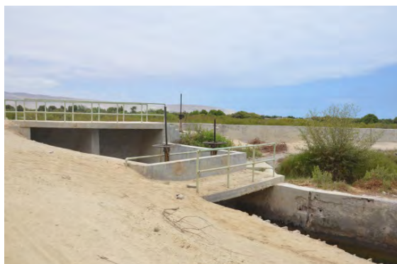
Infraestructura de riego en el humedal
